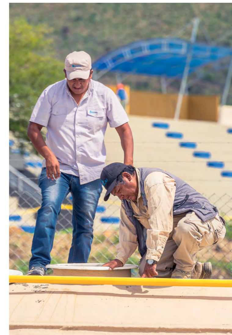
Fotografía: Operación y mantenimiento de la PTAR Tolata
