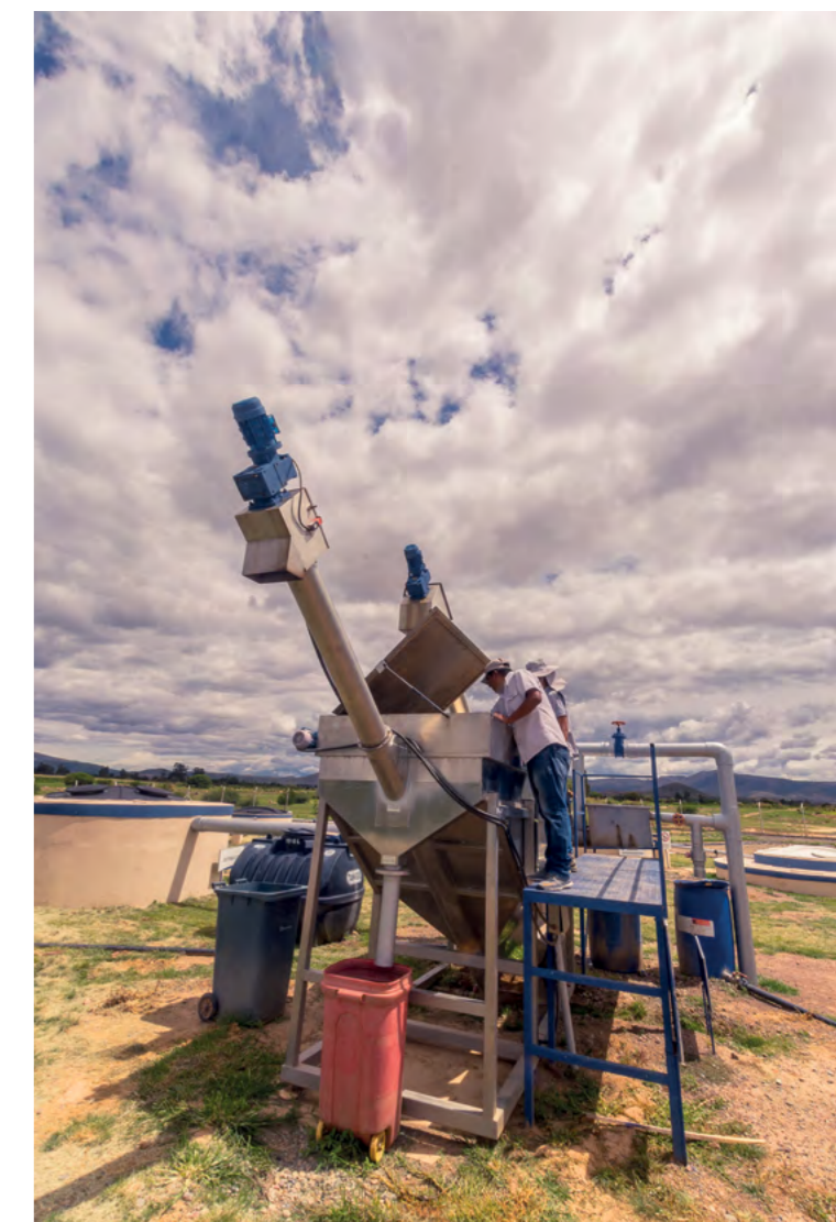
Fotografía: Operación y Mantenimiento PTAR Cliza
