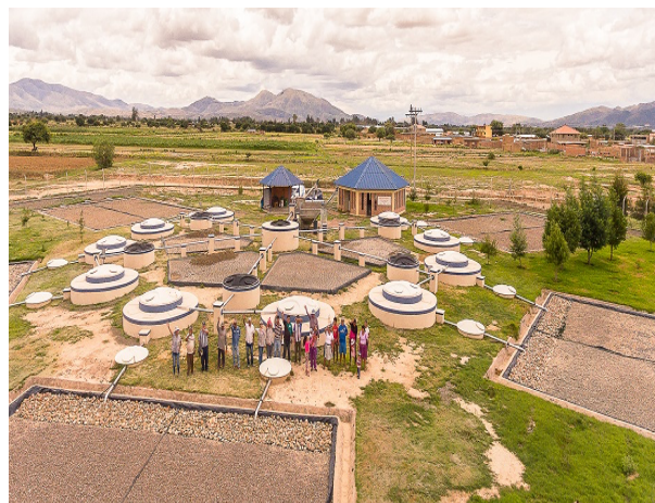
Fig. 3: Planta de tratamiento de aguas residuales municipales de Cliza ( Fundación Aguatuya 2019 )
